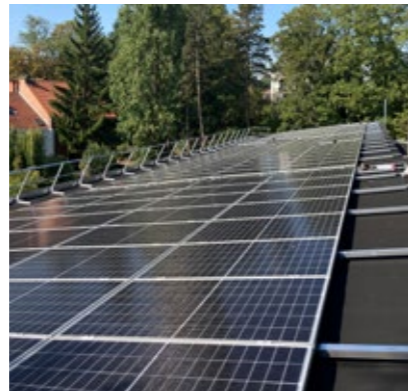
Crèche des roitelets – 141 panneaux photovoltaïques installés cet été.
