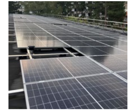
Kinderdagverblijf 'les Roitelets' - hier werden deze zomer 141 fotovoltaïsche panelen geplaatst.
